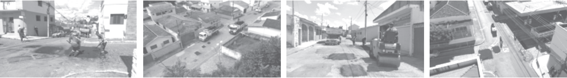
Durante alguns dias, a Prefeitura de Borda da Mata, através da Secretaria de Obras, realizou a operação tapa buraco em diversas ruas do município. Essa ação é fundamental para garantir a segurança dos nossos motoristas e pedestres.
